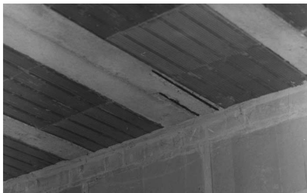
Figura 7 – Problema construtivo. Fonte: Urbel. Fonte: Urbel.
