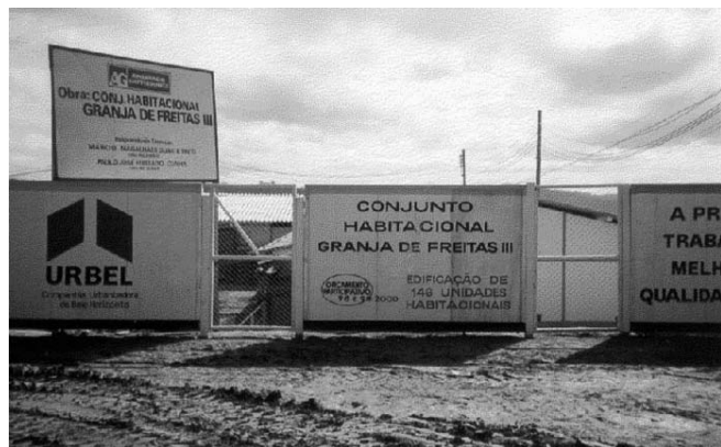
Foto 2 - Canteiro de obras do Conjunto Granja de Freitas III. Foto: Wander Brás, 2001.
