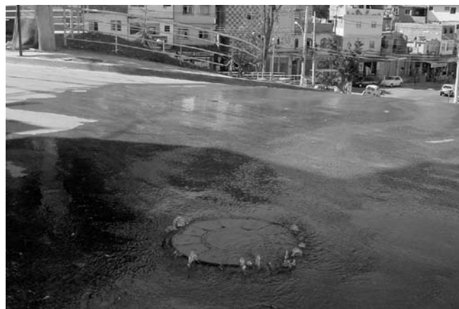
Foto 27 - Apesar das intervenções, a área sofre com inundações. Fonte: Observatório Ippur/UFRJ-Fase
