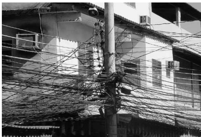
Foto 22 - Edificação de três pavimentos ao fundo e o perigo das ligações clandestinas de luz. Fonte: Observatório Ippur/UFRJ-Fase
